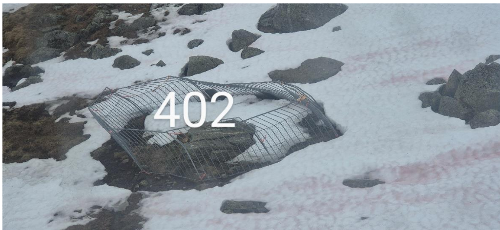
Bildetekst: Grindanlegg 402 i Nordfjella skadet av snøtyngde. Bildet er tatt 22.06.2024.
