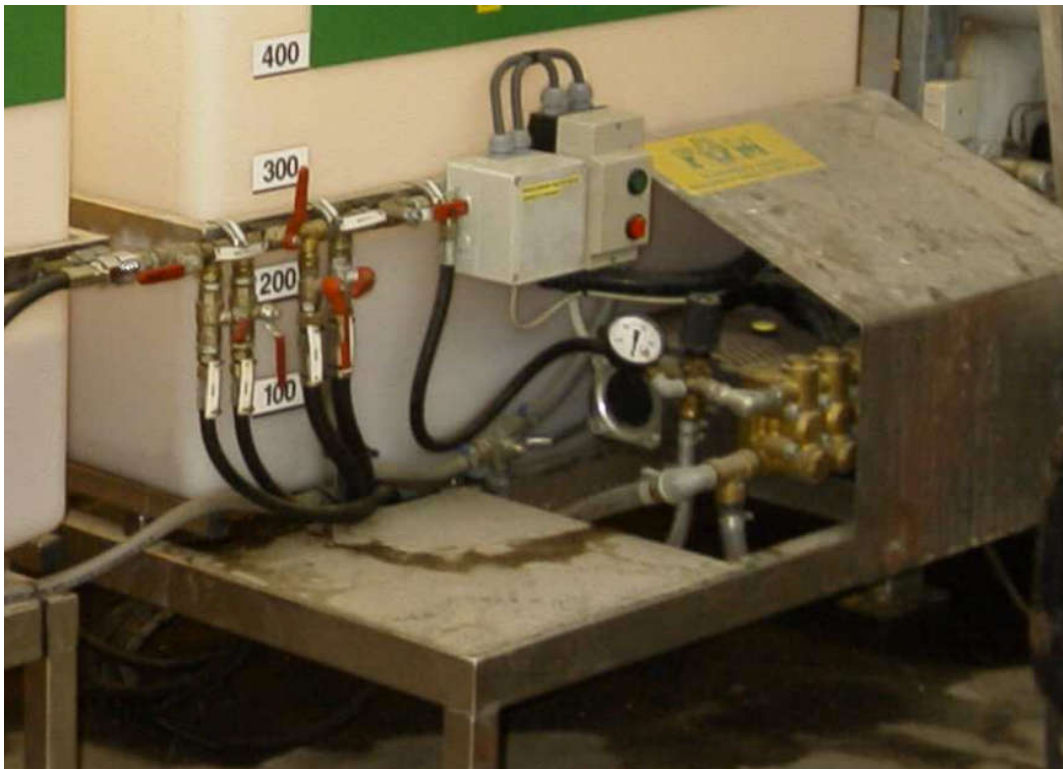
Figur 20 Pumpe og slanger til ulike hus. Det er stor risiko for at det blir stående sprøytevæske over flere dager til neste gangs bruk dersom det ikke foretas nøye tilmåling. Faren for sedimentasjon i tanken er stor.
