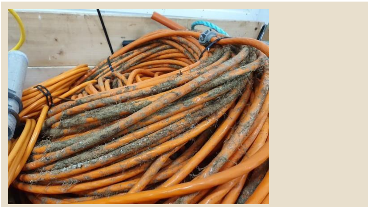
Eksempel på kabel, ikke godkjent
